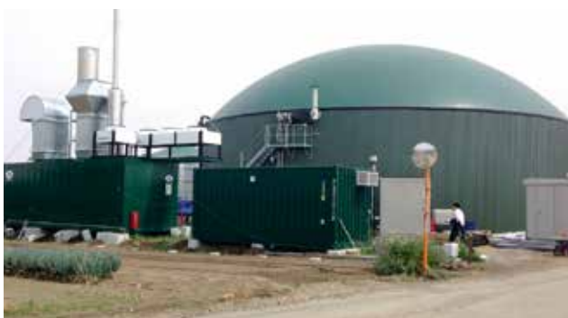
Biogasbehälter mit Doppelmembrandach in Japan Biogas tank with double membrane roof in Japan
