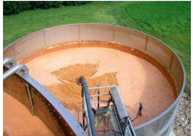
Abwasserbehälter Waste water tank
