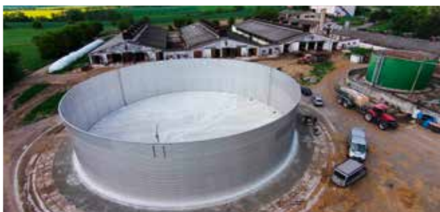
Edelstahlbehälter aus der Vogelperspektive Stainless steel tank from a bird's eye view
