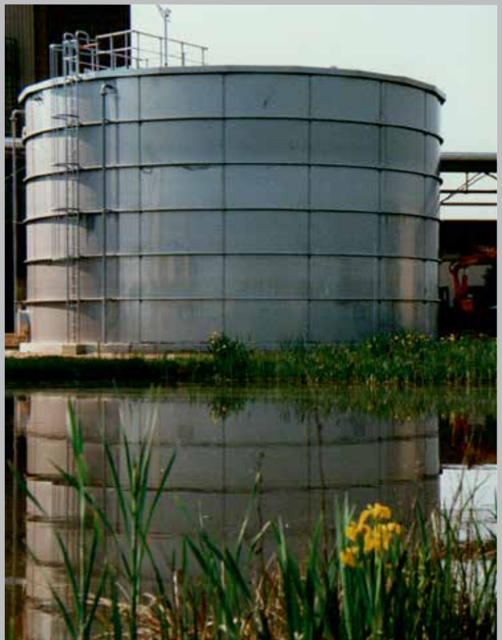
▶ Glattstahlbehälter (Industriebetrieb) ▶ Flat Steel Tanks (Industrial Systems)
