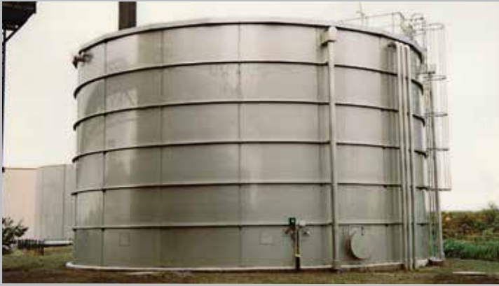
▶ Abwasservorbehälter mit Trapezflachdach ▶ Wastewater Tank with trapezoidal flat roof
